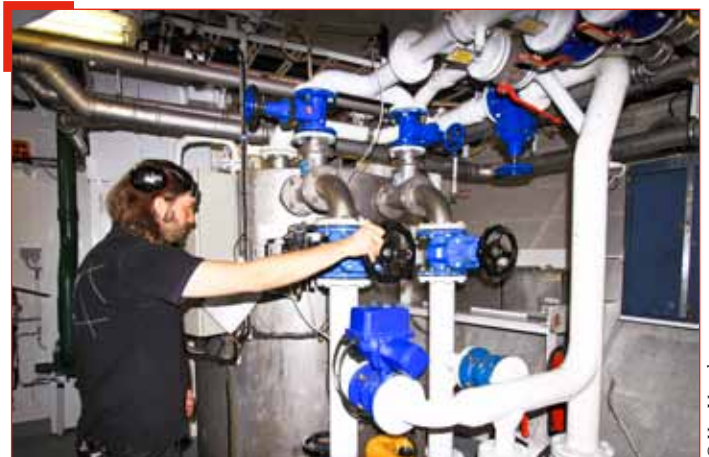
In de machinekamer van de MV Plancius. De dieselelektrische motoren draaien op 'Marine Gas Oil' (MGO) of diesel met een laag zwavelgehalte.
